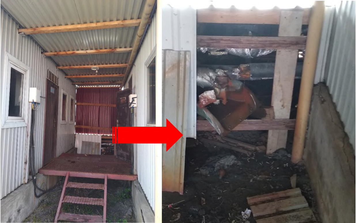
Трубопровод в проходной между помещениями котельной
