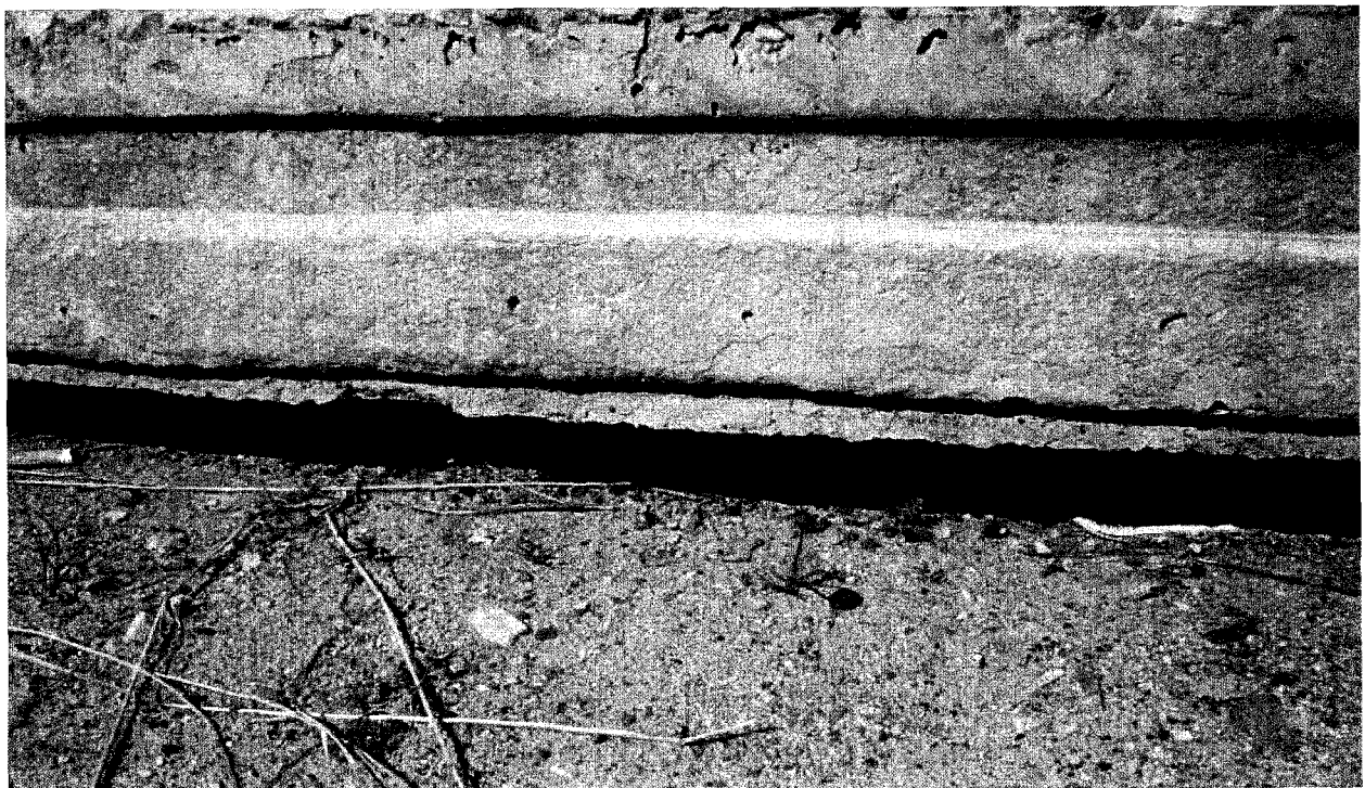
Фото 16. Отсутствие под плитами песчаной подушки из песчано-гравийной смеси
