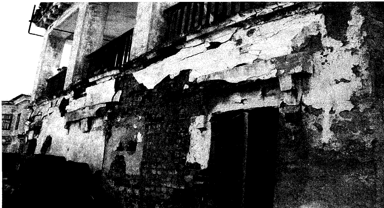
Фото 21. Внешний вид участковой больницы до капитального ремонта
