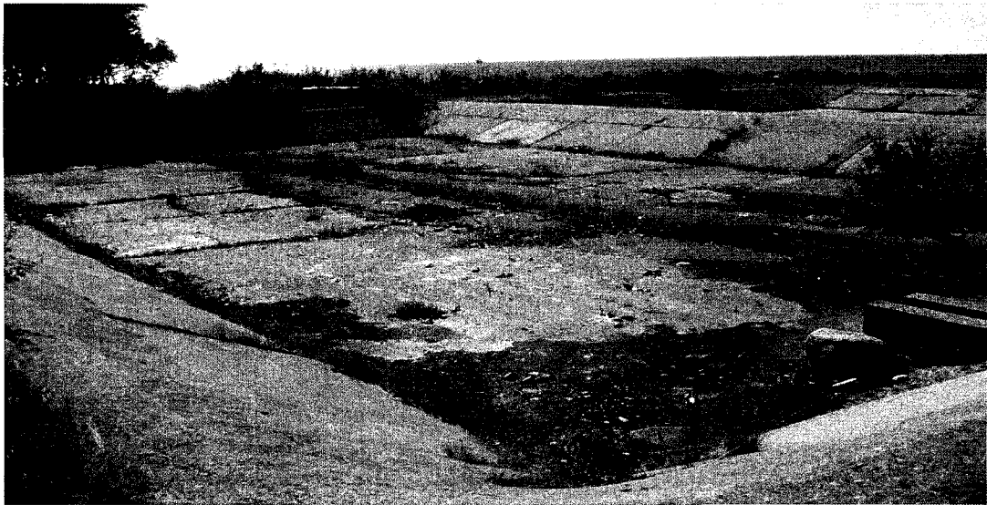
Фото 12. Отстойник очистных сооружений
