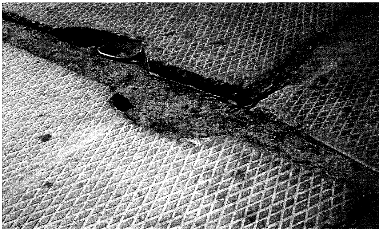
Фото 14. Не заполненные битумом промежутки между плитами
