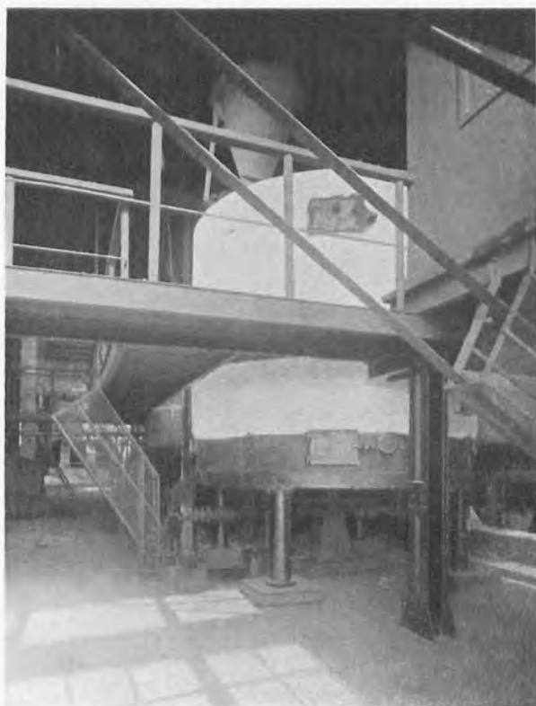
Врабующіяся печи Гересгофа на ангидридномъ заводѣ.
