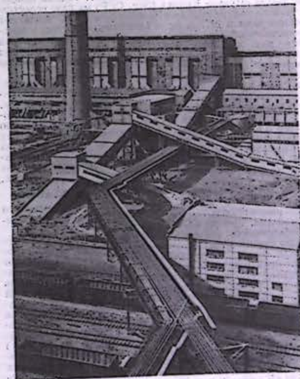
Золопроводы Прибалтийской ГРЭС.
